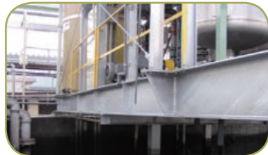
排水処理装置
