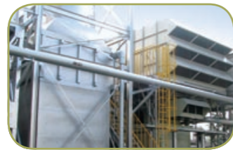
コージェネレーションシステム(名古屋工場)
